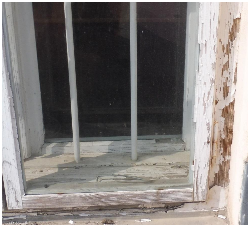
Detailný pohľad na odpadnutú farbu okna s odhaleným drevom a dodatočne vmontovanou mrežou
