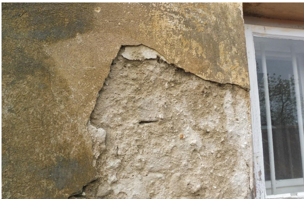
Detailný pohľad na odpadnutú omietku s dutinami a puklinami vo fasáde. Ide o neodborne opravenú a znova odpadnutú omietku
