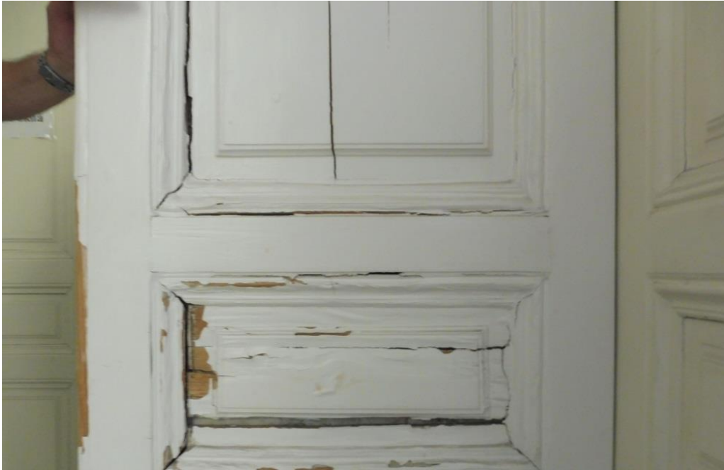
Popraskaná vnútorná vyplň požadujúca zásadnú opravu
