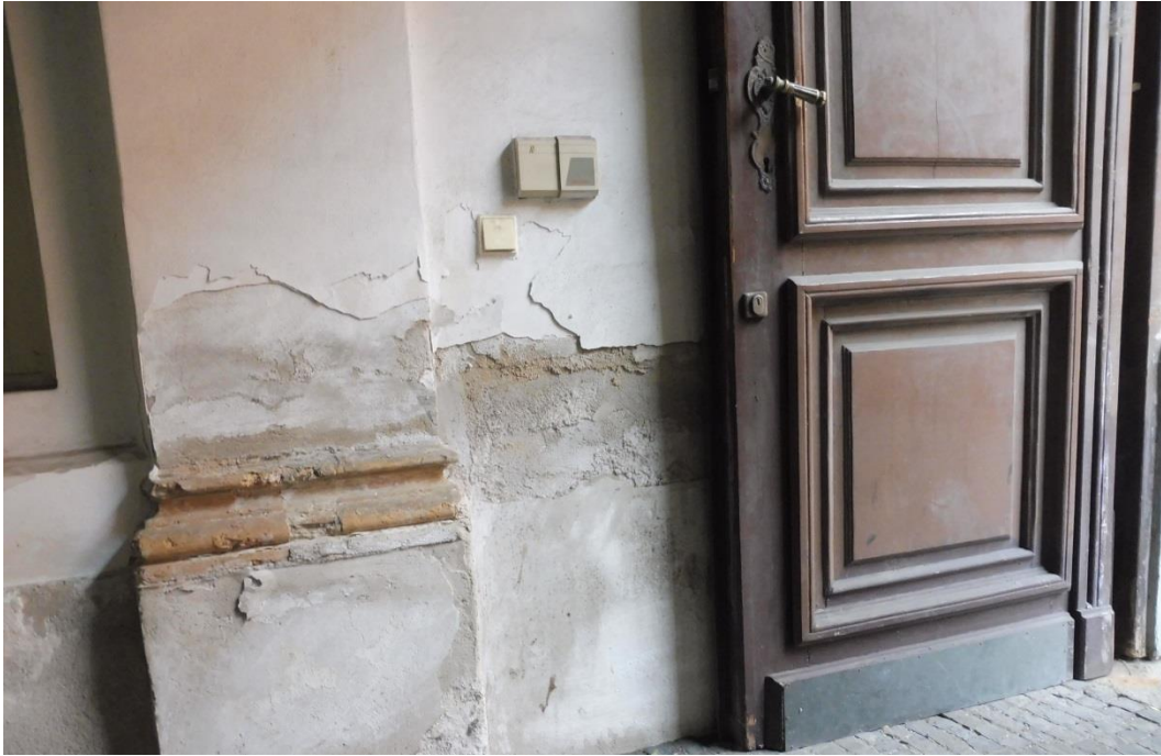
Vchod do budovy zo Štefánikovej ulice so zavlhčenou rozpadávajúcou sa fasádou do výšky cca 1 metra
