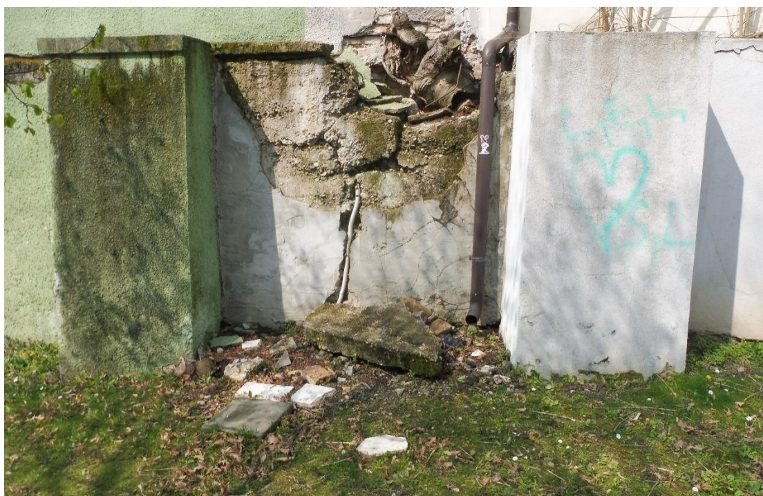
Časť oporného múra úplne rozrušená koreňmi stromu, ktorý v minulosti z neho vyrastal a odhaleným potrubím (pravdepodobne chránička elektriny)
