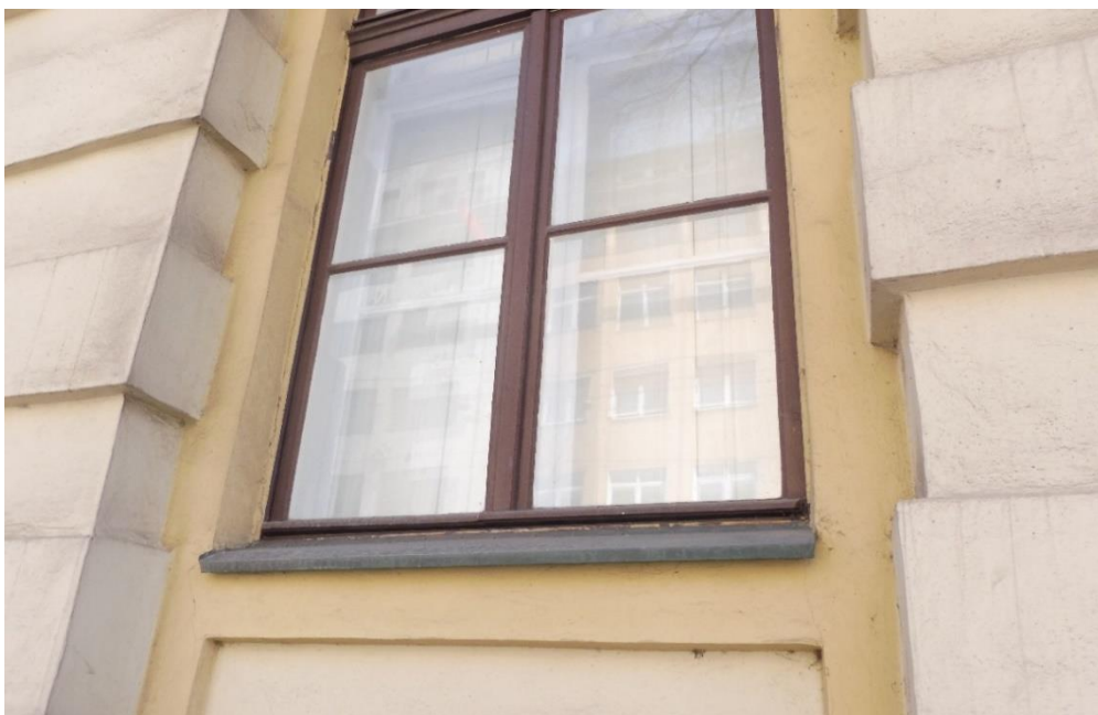
Záber na okno z ulice Štefánikova, rám nesie zvyšky farby a uloženie okna vykazuje pukliny v osadení
