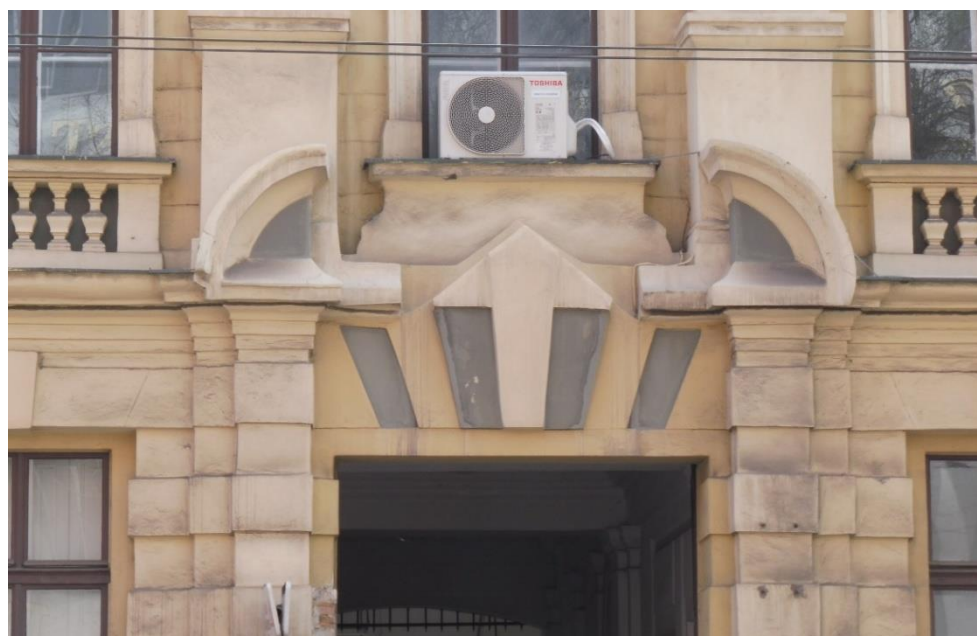
Detail vchodu pre autá s čiastočne poškodenou omietkou a nešetrne namontovanou klimatizáciou
