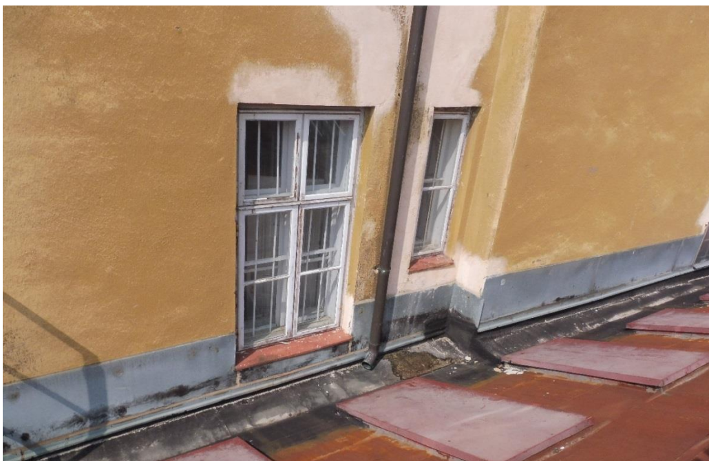
Časť plechovej strechy s odtokom vody a zaplátanými dierami po odpadnutej omietke a odhaleným drevom okenných rámov
