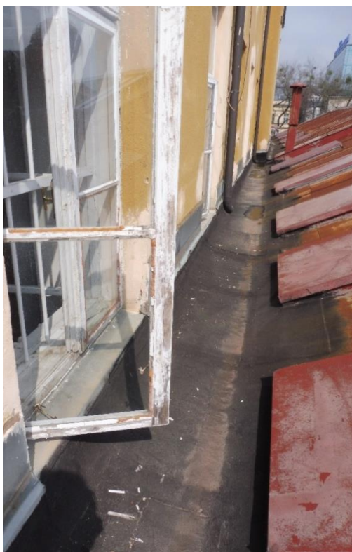
Otvorené okno do strešného priestoru, druhé nadzemné podlažie s rozpadnutým rámom
