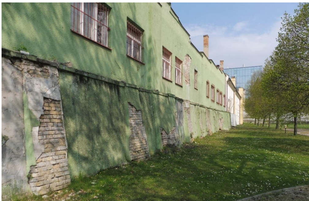
Oporný múr s nadzemnou nadstavbou, zamrežovanými oknami a opadanou omietkou na bývalej terase Karáčoniho paláca
