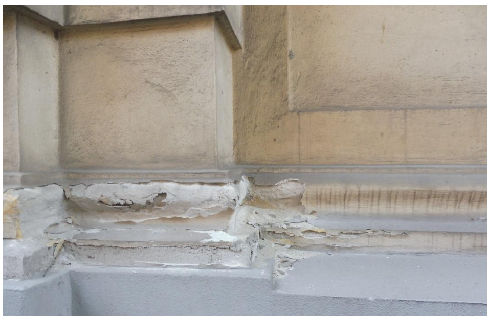
Pohľad z ulice Štefánikova (predná časť budovy). Rozpadajúca sa fasáda v dôsledku prenikajúcej zemnej vlhkosti. Starý systém primúrovky nevyhovuje
