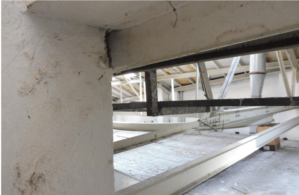
Pohľad z okna Karáčoniho paláca prekrytého strešnou konštrukciou so stopami odpadajúcej omietky a vlhkosti zo zatekania strechy
