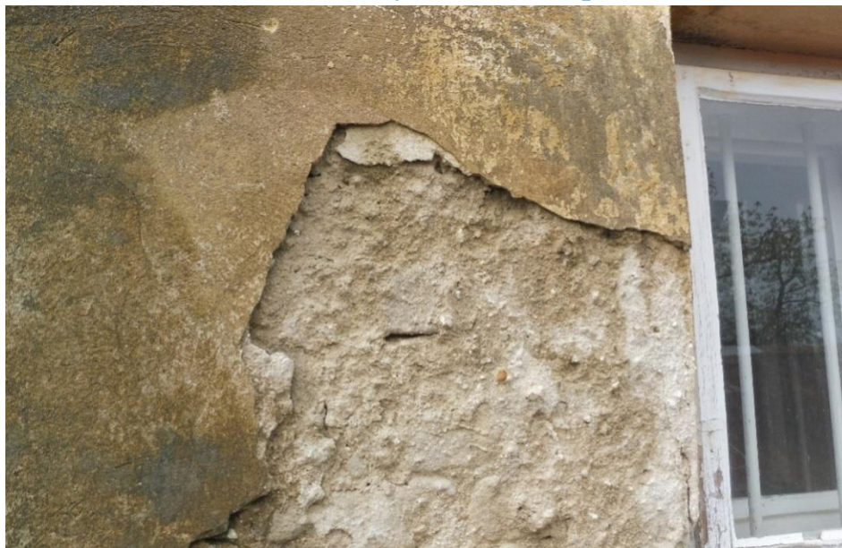
Devastačný rozpad omietky vo výške druhého nadzemného podlažia nad strechou železnej prístavby
