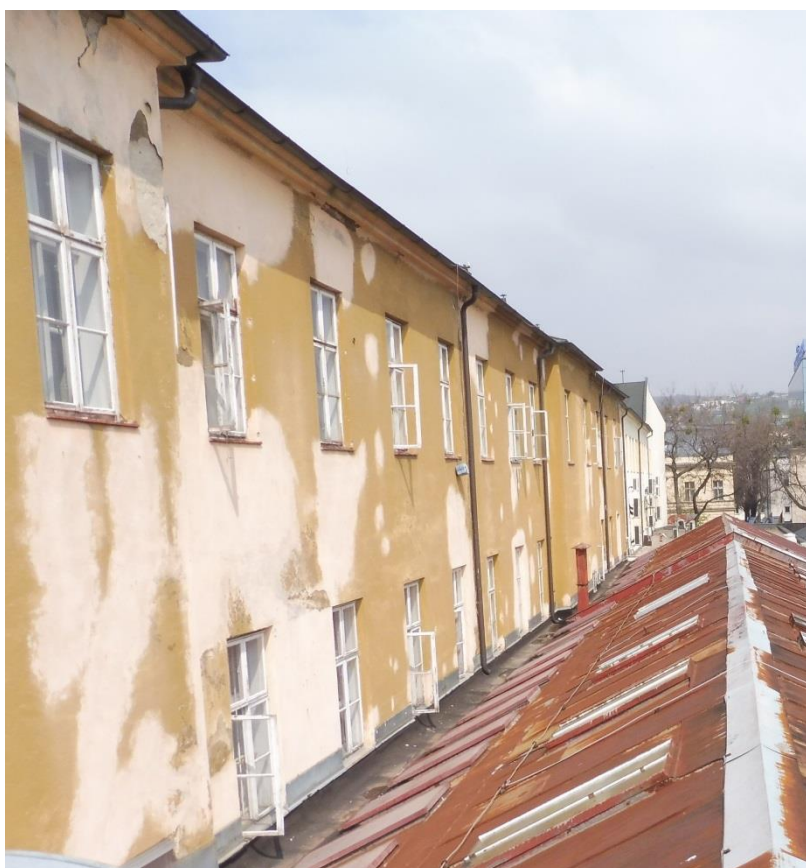
Celkový pohľad na hrdzavú strechu so zaslepenými svetlíkmi a „záplatami“ na celej zadnej stene na druhom a treťom nadzemnom podlaží (cca 30 rokov neúdržby)
