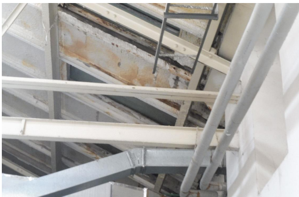
Medzipriestor so zatekajúcimi plechovými panelmi, kde chýba krycia farba
