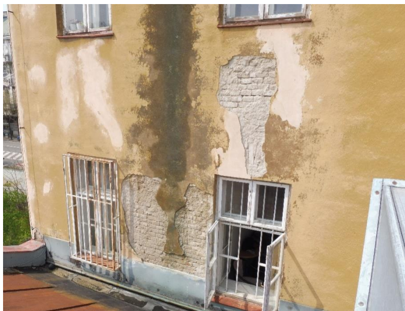
Vyrezaný otvor v mreži (z kuchynky) umožňujúci inšpekciu strechy a provizórne opravy fasády značne rozrušenej s odhalenými tehľami a nedostatočnou opravou (sivý pás napravo a biele fláky opráv na fasáde)
