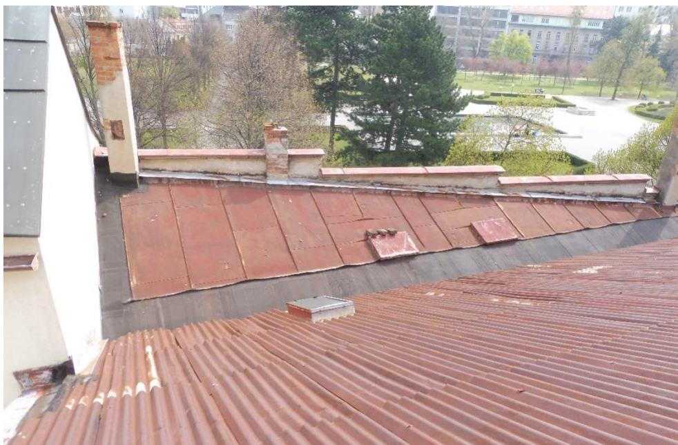
Časť plechovej strechy pokrytej hrdzou a zvyškami ochranného náteru
