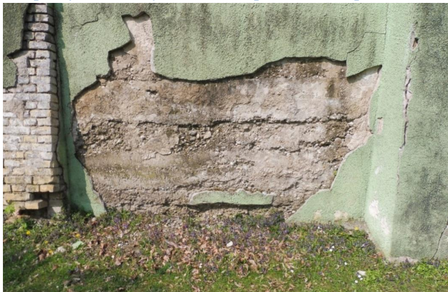
Devastačný rozpad omietky s rozpadávajúcim sa podkladovým betónom oporného múra
