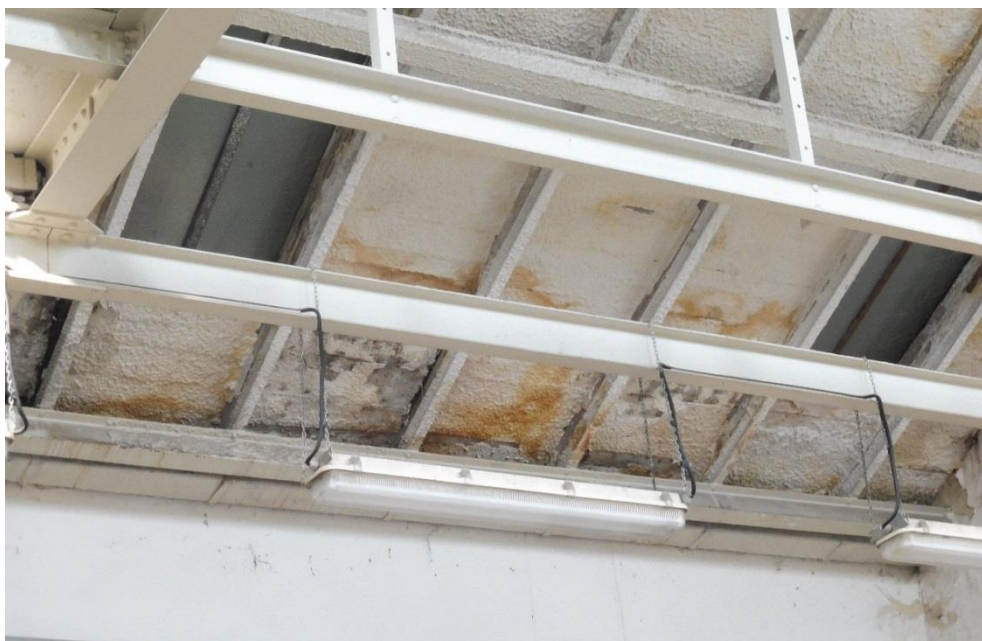
Pohľad na strešnú časť železnej konštrukcie plechovej strechy so zaslepenými svetlíkmi so znakmi hlbokej korózie plechu
