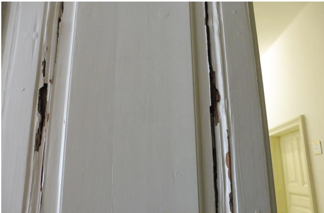
Deštruovaný dverný rám vyžadujúci výmenu
