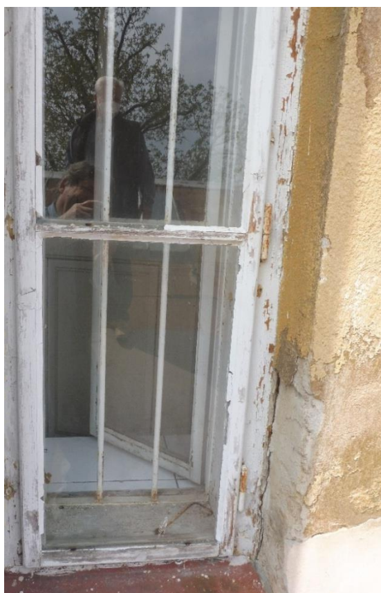
Úzke okno s poškodeným rámom, odpadnutou omietkou a popraskaným osadením
